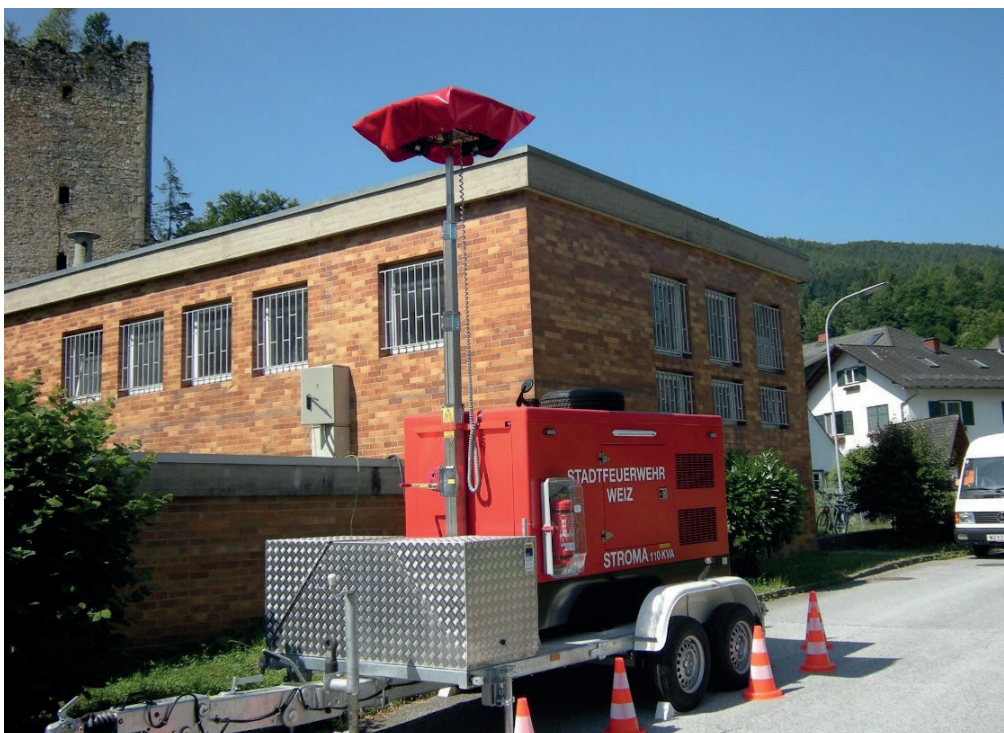
Wasserversorgungsanlage in Sturmberg mit einsatzbereitem Notstromaggregat
